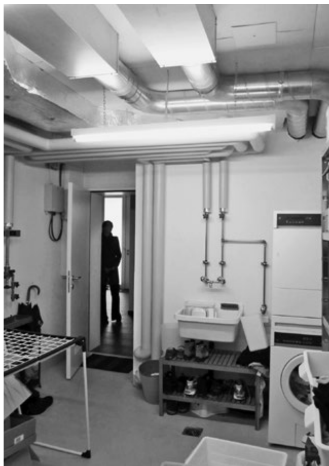
Abbildung 3: Technikraum ausserhalb der thermischen Gebäudehülle
