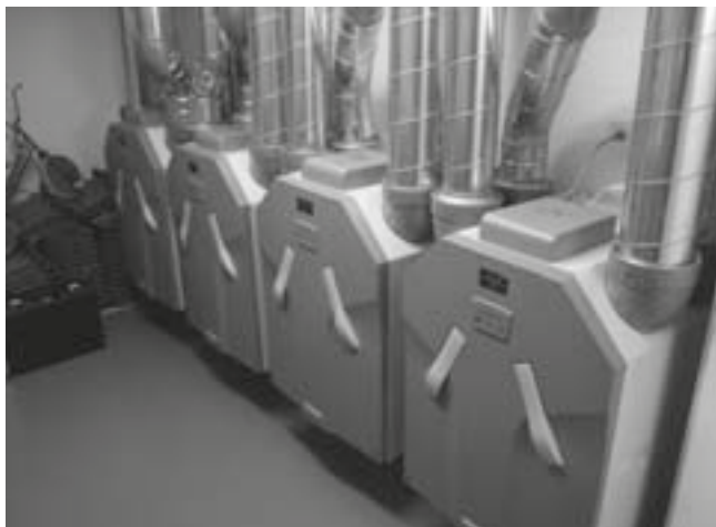
Unabhängig wo sich dieses Lüftungsgerät befindet – mindestens zwei Kanäle müssten wärmedämmend sein.
