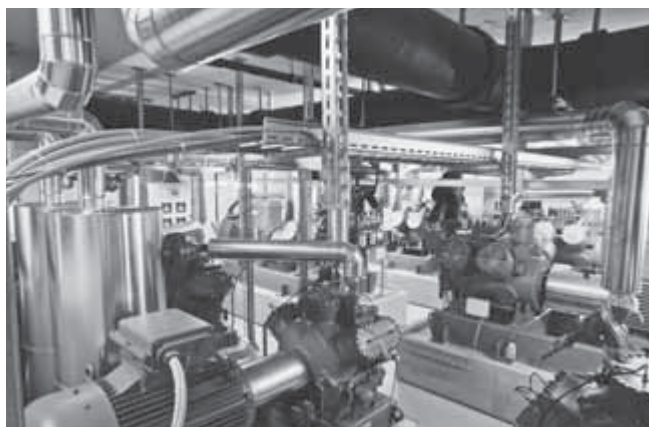
Blick in das Herzstück des Verbundes: die Ammoniak-Wärmepumpe.
