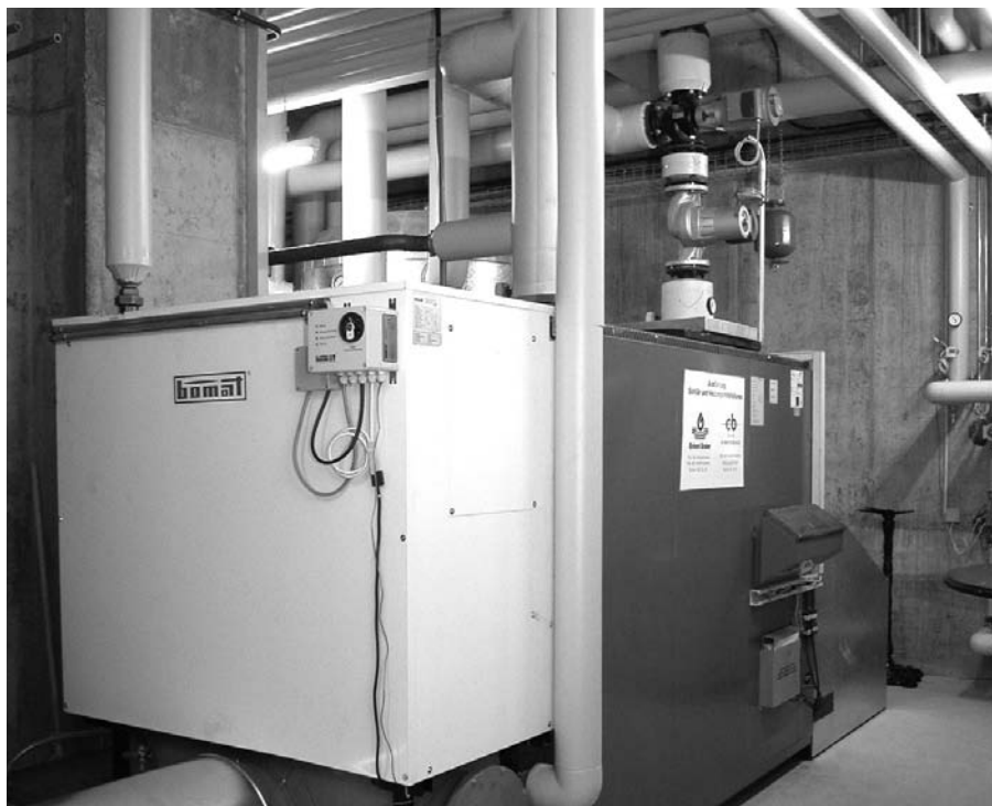
Heizungssanierung in einem Hotel. Das Bild zeigt den Kessel und den hinten am Kessel angebauten Abgaswärmetauscher für die Brennwertnutzung (Foto Lauber IWISA).
